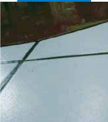
Détail de l'application d'Ultraplan sur carrelage existant avec application préalable de Mapeprim SP
