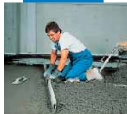
Etalage et damage du mélange Mapecem
